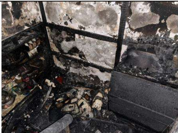
說明：2樓通往3樓樓梯，雜物堆積，走道燒
